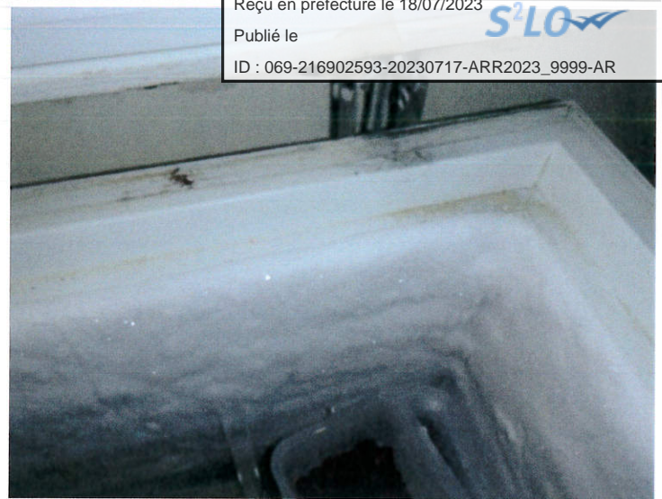
Enceinte froide négative intérieur atelier boulangerie
