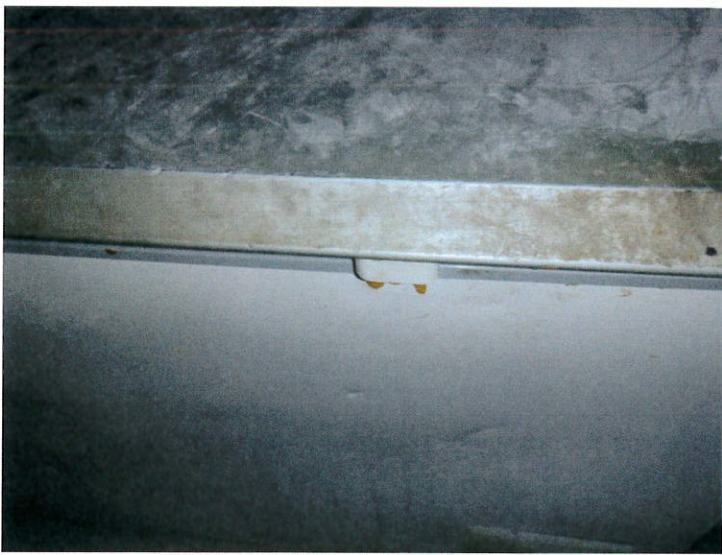
Enceinte froide négative extérieur atelier boulangerie
