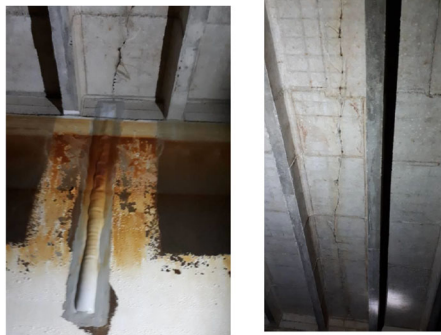
Photos fissures voûte et couverture - cuve 2
