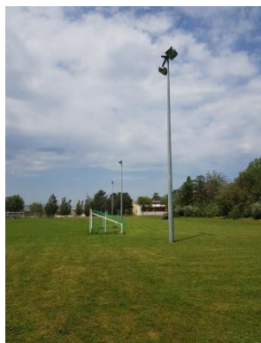
Eclairage existant à 3 mats par côté
