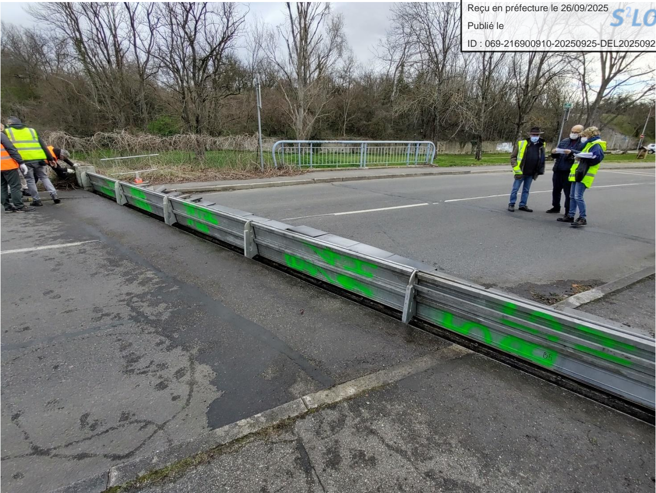
Figure 1 : Batardeau de la commune de GIVORS, faisant partie des ouvrages de protection locales du système d'endiguement n° 4 du SMAGGA
