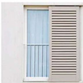
Volets métalliques à lames orientables Occultation de l'ensemble des ouvertures Nord et Ouest
