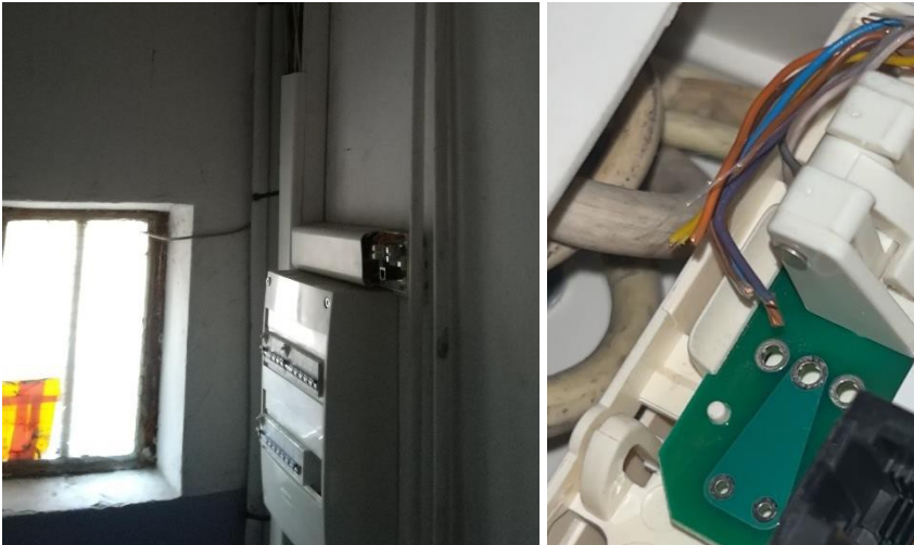
Local technique au rez-de-chaussée : Fils électriques sectionnés
