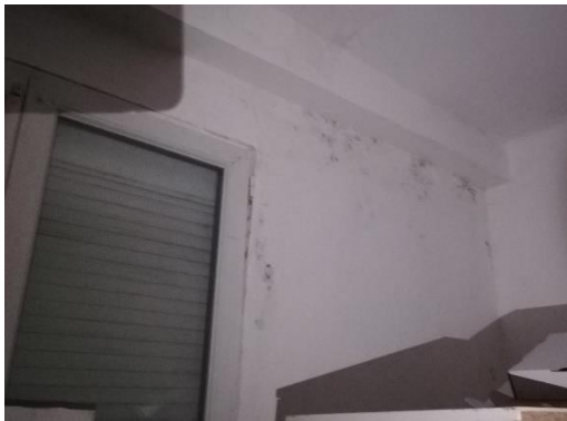
Chambre : Absence d'éclairage naturel
