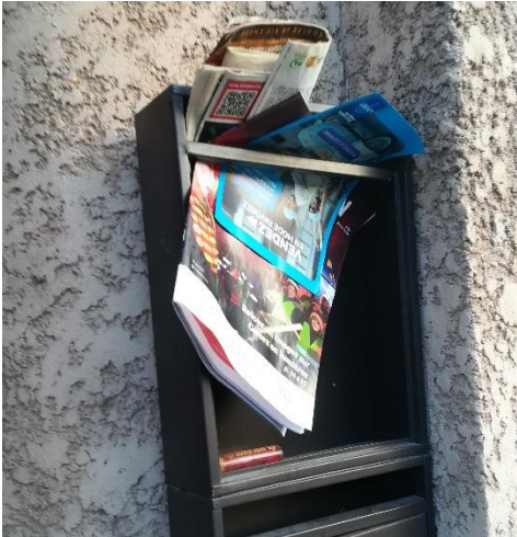
Extérieur : Boîte aux lettres de la locataire dégradée
