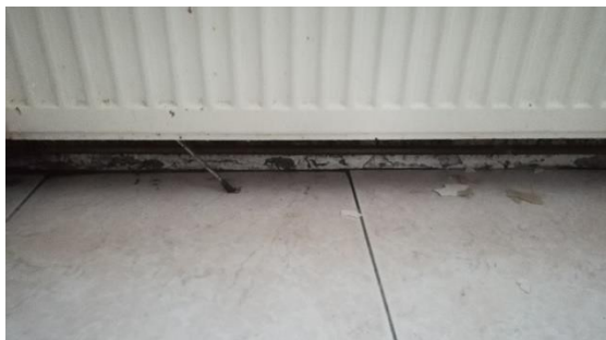
Cuisine : Quelques traces d'humidité sous le radiateur
