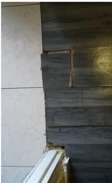
Chambre : Revêtement dégradé du salon
