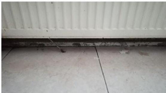
Cuisine : Quelques traces d'humidité sous le radiateur
