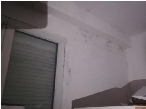
Chambre : Absence d'éclairage naturel
