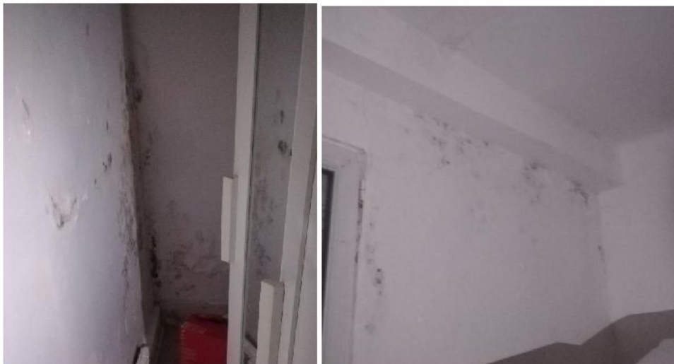
Chambre : Traces de moisissures sur le mur de façade
