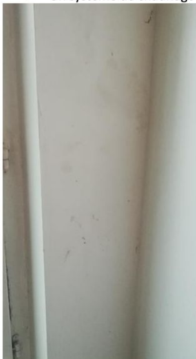
Cuisine : traces de moisissures sur le mur de façade côté fenêtre
